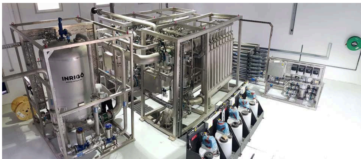
Inrigos hovedleveranse i Kamerun-prosjektet. Skid-baserte vannbehandlingsanlegg basert på keramisk membranfiltrering. Det installeres totalt 14 slike filterkomponenter i prosjektet. (Foto: Inrigo)
